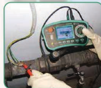
Continuity check of equipotential bonding
