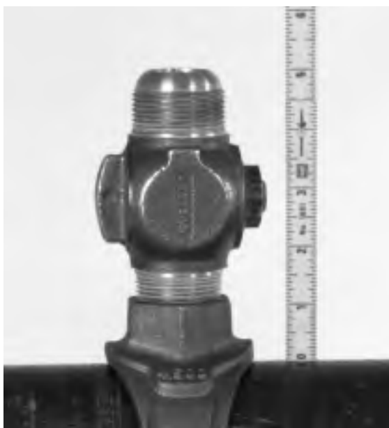
Figure 8 – Relevé du décalage de la vanne.
