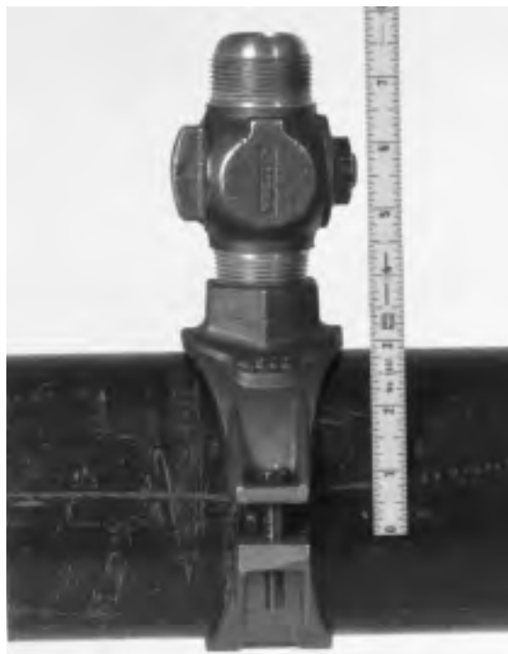
Figure 9 – Relevé du décalage de la vanne.
