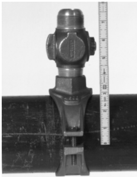
Figure 9 – Relevé du décalage de la vanne.
