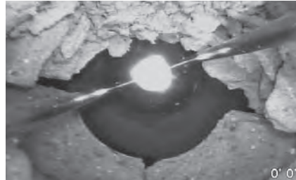
Figura 13 – Agujero que atravesó una alcantarilla
