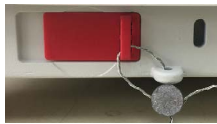
Bloqueado con cable de sellado
